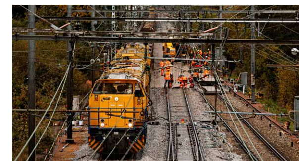
Remplacement d'un appareil de voie sur LGV de 220 m de long à Connerré (72)
