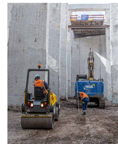
Station de dépollution des eaux pluviales à Champigny-sur-Marne (94)
