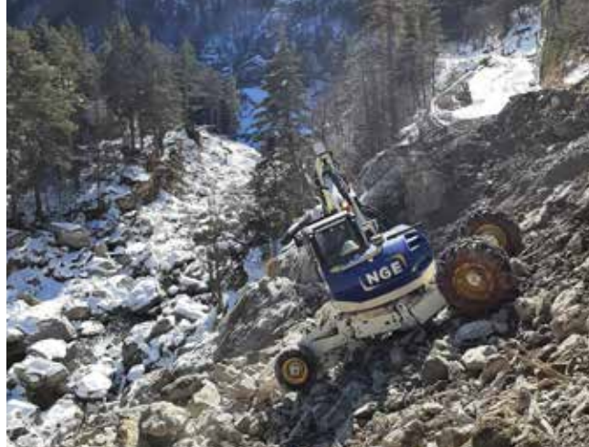
NGE au chevet de la Vallée de la Roya. Ici, la pelle araignée réalise les premiers sondages
